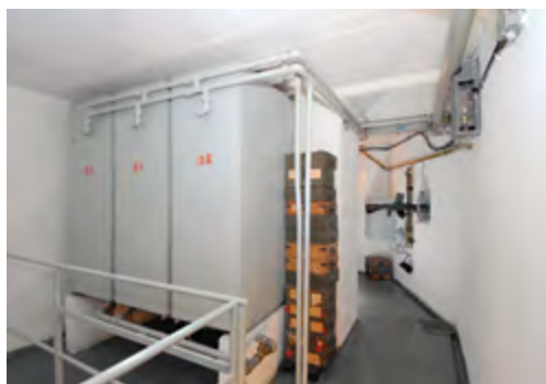
Nádrže na vodu v MO-S 19 Alej
