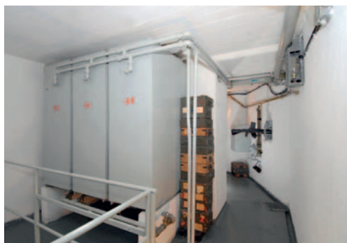
Nádrže na vodu v MO-S 19 Alej
