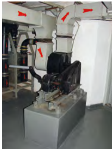
Stacja filtrów w MO-S 19 Alej
