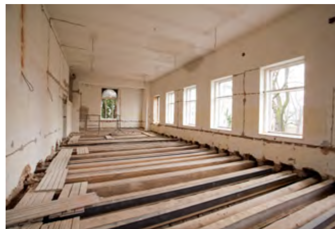
Strop napadený dřevomorkou. Foto: Archiv SZM.
